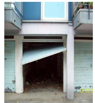
Broken garage door
